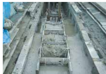
NS-BOX設置状況
