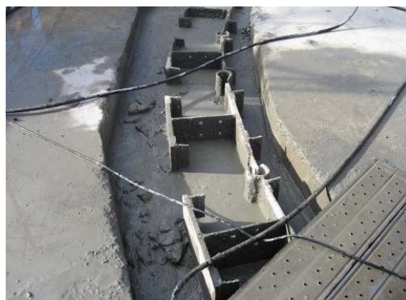
図一参 3.11 建込み完了状況 「鋼製地中連続壁協会」資料による
