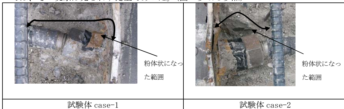
図－参 3.4 溶接カプラー近傍コンクリート状況
